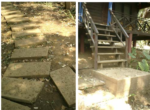
ຂັ້ນໄດ ແລະ ທາງຢ່າງທີ່ຂຶ້ນເກີນຂອບເຂດ ຈະເຮັດໃຫ້ແຂກ ພະລາດລົ້ມໄດ້ຢ່າງງ່າຍດາຍ.
